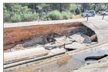
Tramo averiado del trasvase.
