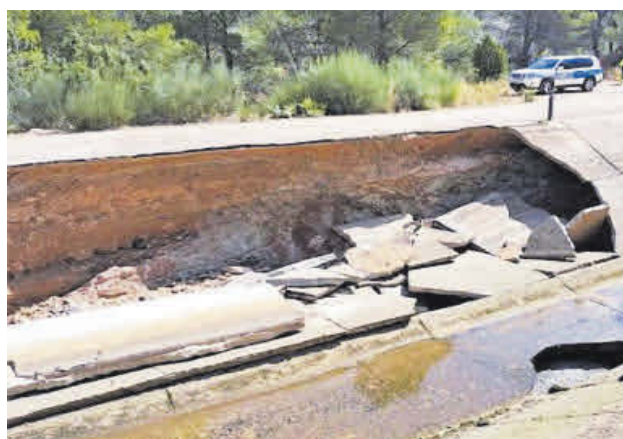
Rotura del canal a la altura de Liétor.
